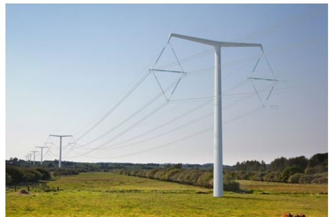
T-förmiger Mast, Großbritannien / Foto: National Grid
